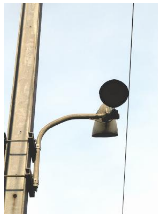
Eclairage des quais toujours au sodium lors de notre visite
