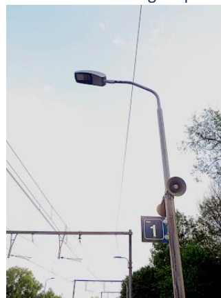
Ce sont déjà des LED qui éclairent le point d'arrêt
